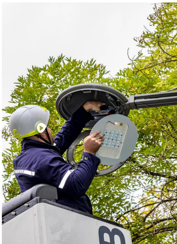
©CH.Ruiz/Montpellier3m - Source Montpellier Méditerranée Métropole Eclairage Public – Passage aux Leds
